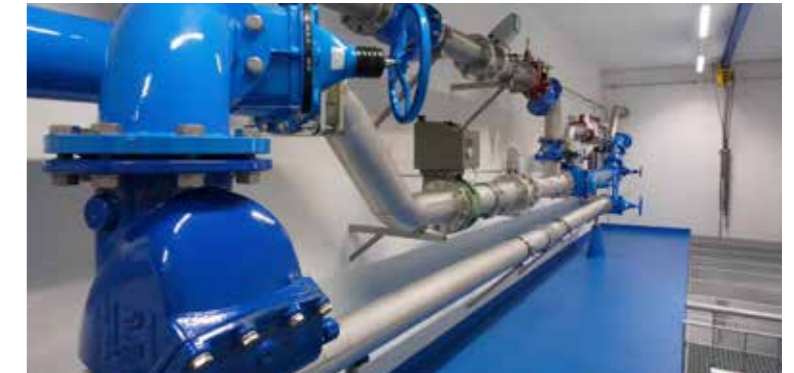
Die Wasserversorgung Ebikon-Dierikon wird per 1. Januar 2022 abgeschlossen.
