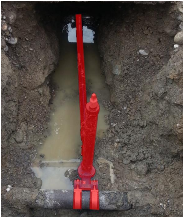
Abbildung 1: Anbohrschieber mit Hausanschlussleitung
