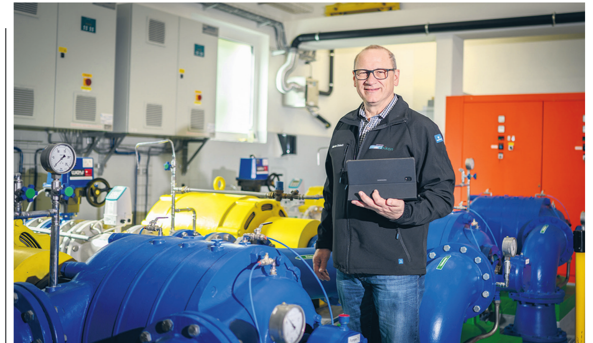
Markus Dubach, Leiter Wasserversorgung, bei seinem Kontrollgang im Pumpwerk Schiltwald: «Unser Wasser kann man direkt ab Pumpe trinken.» Bild: Anian Heierli
